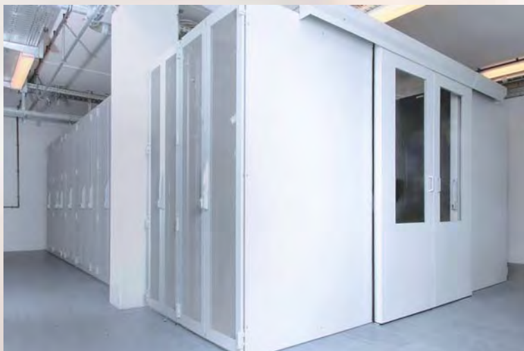
Les serveurs de la société Manner ont trouvé place dans 14 baies TS IT de Rittal, installées dans deux rangées qui se font face pour former l'allée froide.
