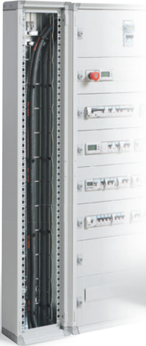
Gaine externe équipée d'un chemin de câbles
